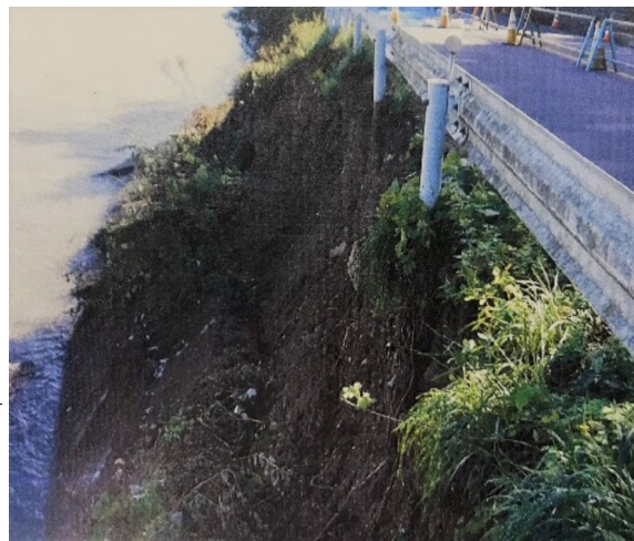
少林山通りの崩れた護岸
